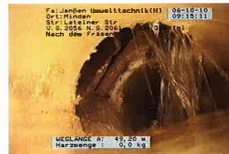
Stutzen mit starkem Grundwassereintritt in Minden vor der Sanierung.
