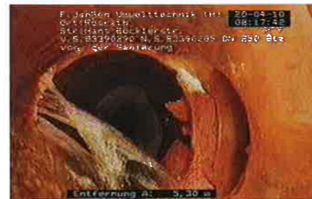
Stutzen in Rösrath mit starkem Grundwassereintritt vor der Sanierung.
