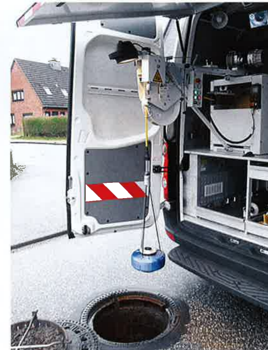
In wenigen Minuten Einsatzzeit wird die gesamte Innenansicht des Schachtes als Datensatz erzeugt.
